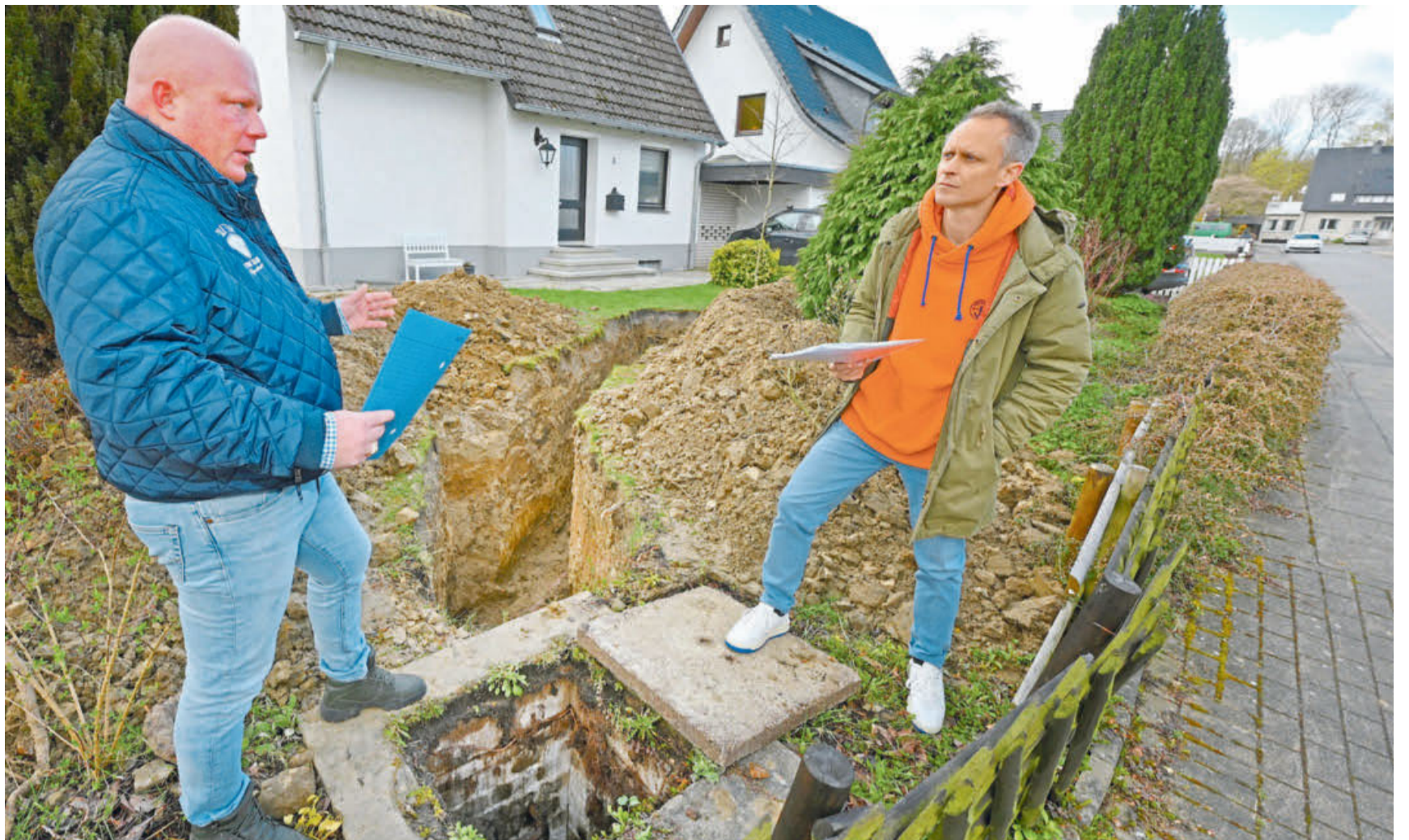
Sachverständiger Maik Menke (links) und Hausbesitzer Gunnar Kreutner vor der Baustelle, wie sie die Monteure hinterlassen haben.
